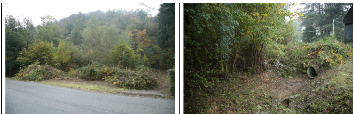
Area S 13 – In fregio alla SP 42 si osservano le criticità idrauliche connesse alle precedenti modificazioni dell'alveo del Rio Prabasone
